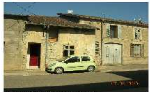
26A Grande rue (0100) réhabilitation partielle à conforter
