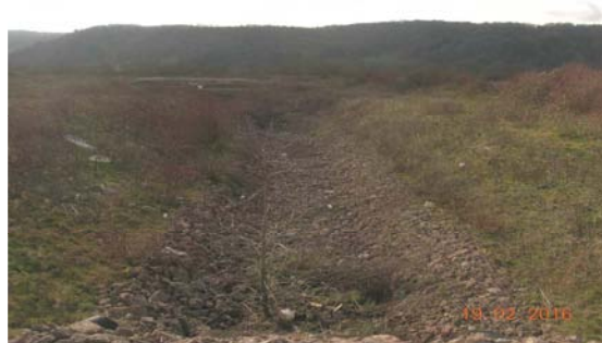
Noue pour la rétention eaux pluviales
