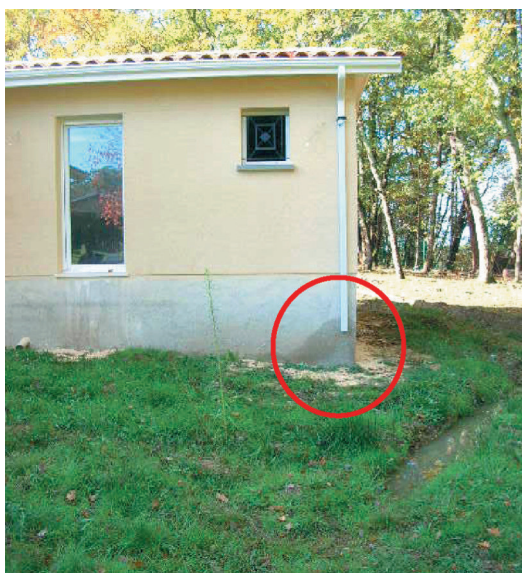
Figure 14 Défaut de gestion des eaux pluviales (Source Socabat)
