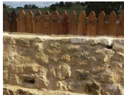
Muret avec gîtes (trou dans le mur) (source :LPO)
