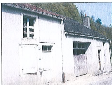
Quelques maisons qui se dégradent au cœur du village
