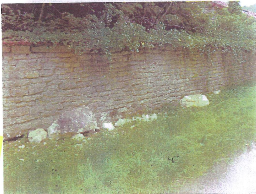
Illustration 5 : Vue particulière sur les blocs non déplacés et les traces de calcaires sur le mur
