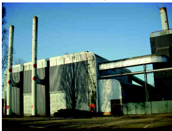
Les chaudières (Vitry-Habitat)
