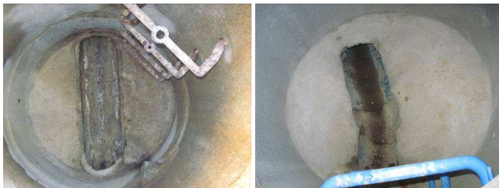
Fig. 12 : Etat visuel des regards du réseau eau pluvial
