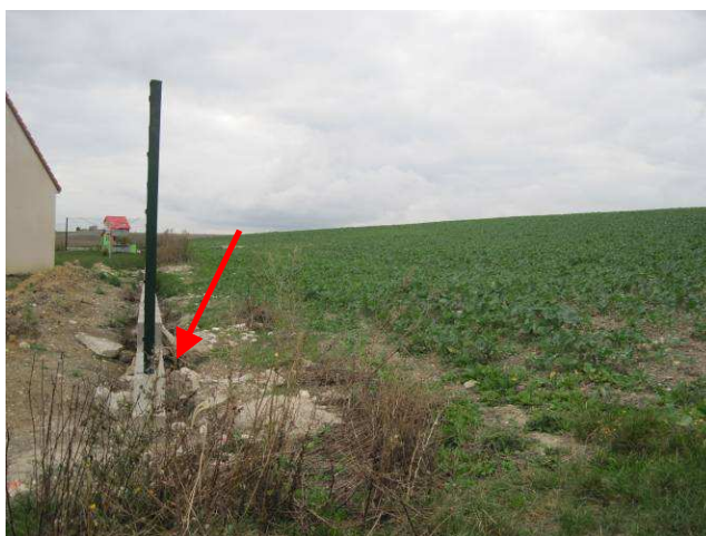
Fig. 29 : Présence d'érosion chemin de Lhéry en amont d'une habitation
