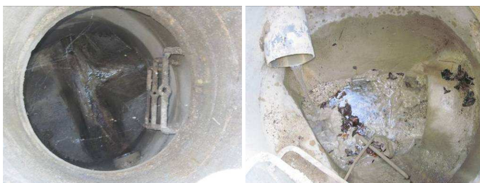
Fig. 13 : Problème d'encombrement au niveau des regards
