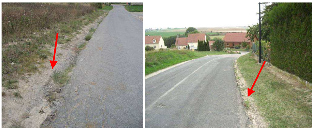
Fig. 28 : Présence d'érosion chemin de Lhéry (gauche) et RD424 (droite)
