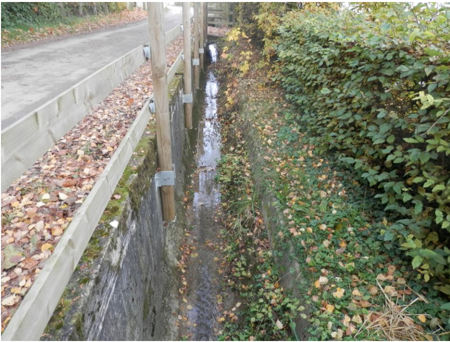
Figure 8 : illustration de l'écoulement (rue de Saint-Martin).
