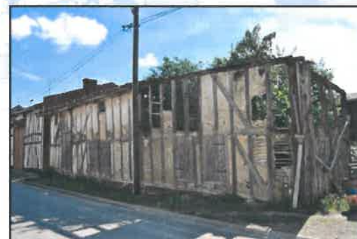
Maison en ruine Source TOPOS
