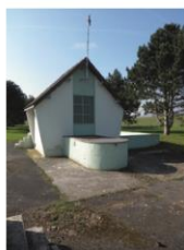
Captage AEP Puits 2 de Gueux
