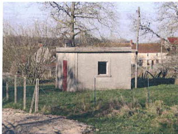
Captage d'eau de Corrobert
