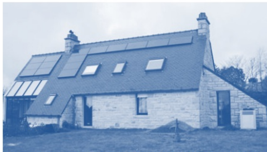
Panneaux solaires groupés en bandeau en retrait du faitage sur la toiture principale et panneaux solaires installés sur la toiture secondaire.
