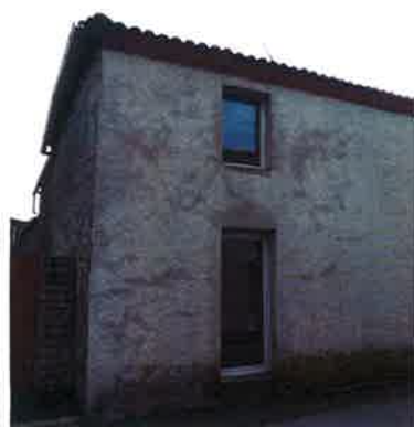
Des enduits inadaptés
