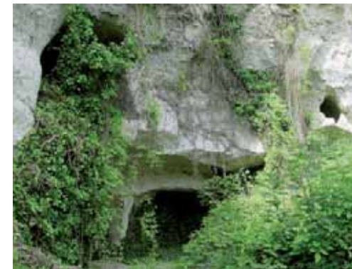
DÉFAUT D'ENTRETIEN DE LA VÉGÉTATION
