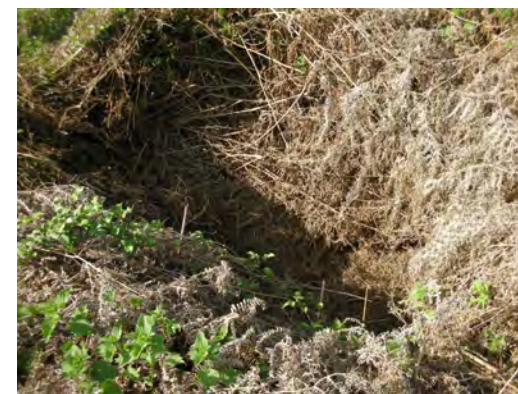
Photo 1: Ind 004, vue de l'effondrement en sommet de la motte
