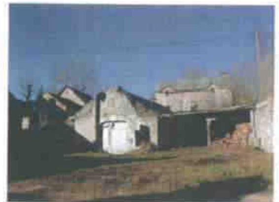
Bâtiment en ruine
