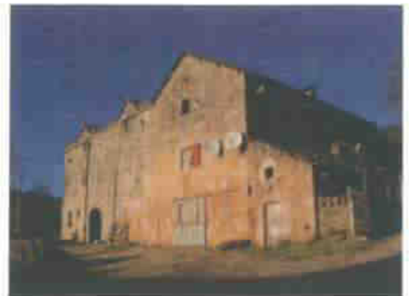
Installation peu judicieuse de paraboles
