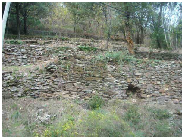
Détail d'un bancel traditionnel encore debout, mais menacé d'écroulement.
