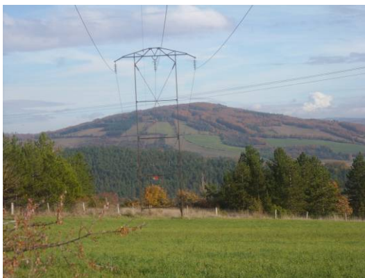
La ligne moyenne tension grève la constructibilité des terrains situés à proximité
