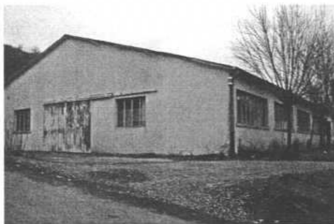
Bâtiment artisanal désaffecté (artisans de Lozère)
