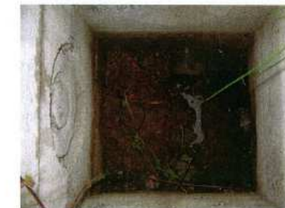
Regard de répartition
