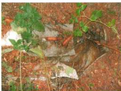
Rejet sous la RD 88 ne présentant pas de risque sanitaire ou impact marqués
