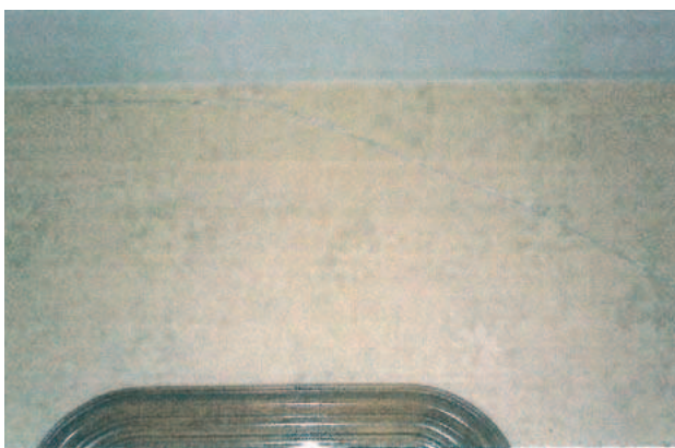
Fissuration intérieure, tapisserie déchirée - Maison André.
