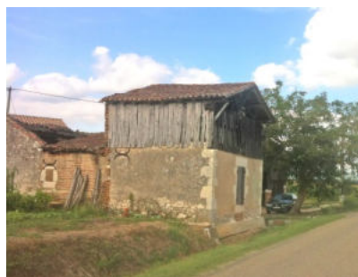
Grange avec toiture effondrée, secteur Gamot, © UrbaDoc 2014
