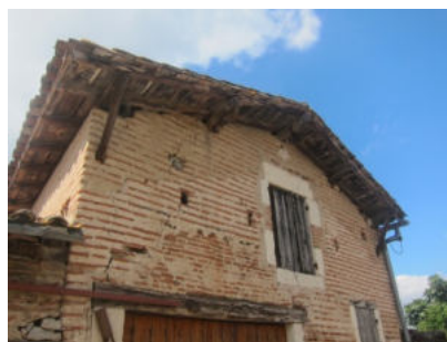
Bâtisse traditionnelle dans le village de Lafitte avec quelques lézardes sur la façade (appareillage briquettes et mortiers), © UrbaDoc 2014
