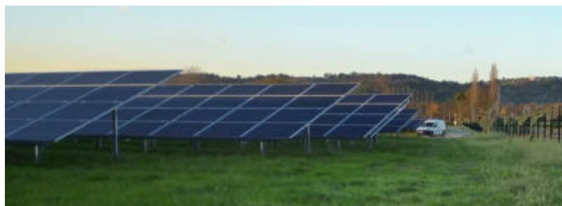
Parc solaire implanté en marge de la RD 666, non loin de Granges sur Lot, © Luxel.fr
