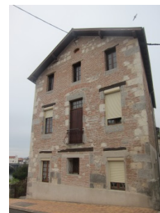
Volet coulissant : matériau et coloris peu enclins à s'harmoniser avec la façade.
