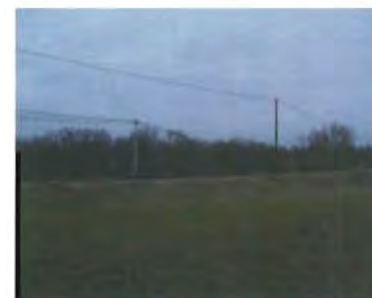
1 Ligne à HT RD 10
