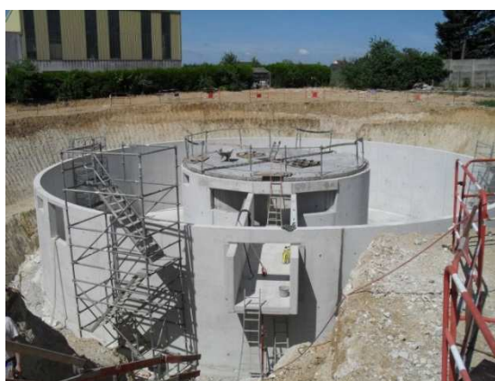
Bassin de rétention en béton armé
