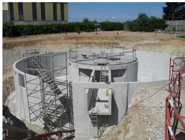
Bassin de rétention en béton armé
