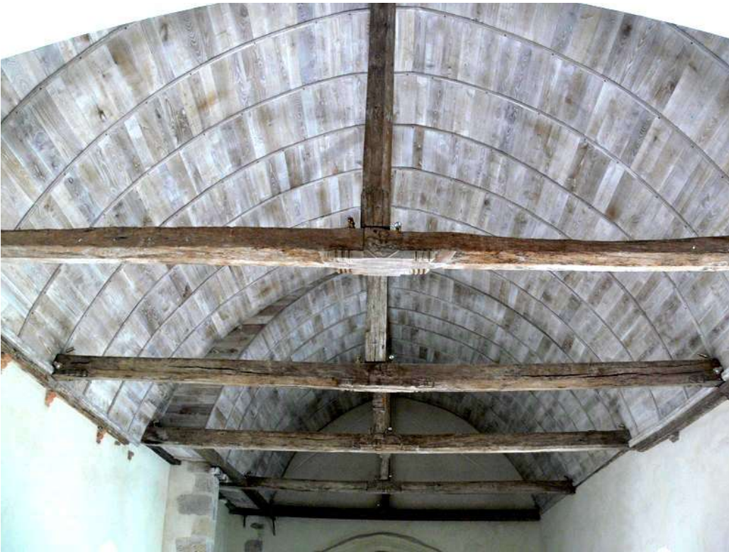
La charpente de la nef après dégagement et restauration - cliché CRMH – DRAC Centre-Val de Loire
