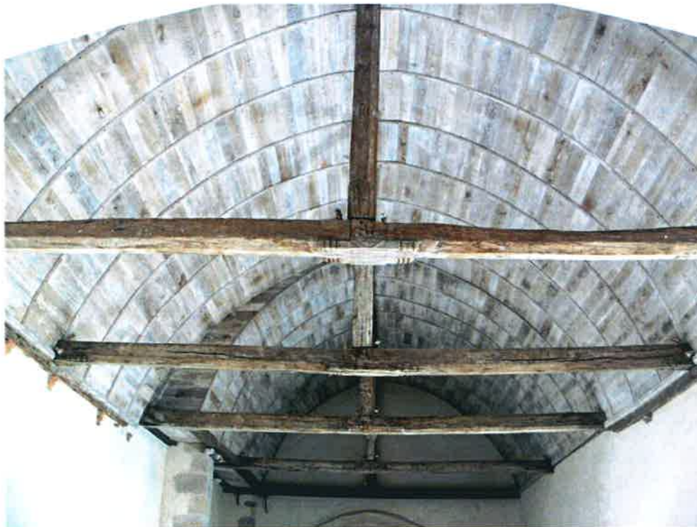
La charpente de la nef après dégagement et restauration - cliché CRMH – DRAC Centre-Val de Loire
