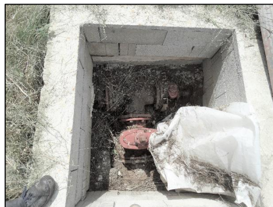
Figure 2 : Conduite raccordée au trop plein et vidange du réservoir – Vanne tamponnée
