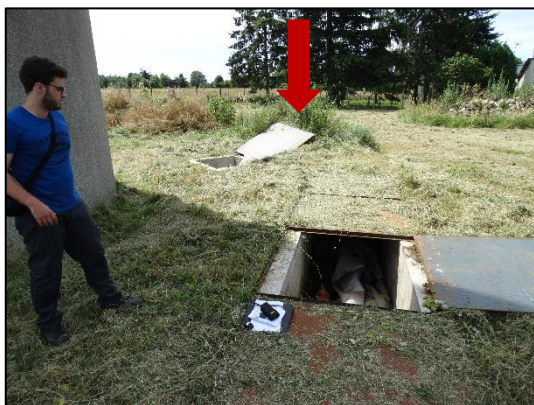
Figure 1 : Ancien forage situé à proximité du château d'eau sous le tas de terre
