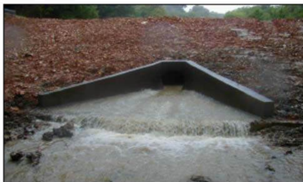
Figure 13 : Ouvrage de diffusion du débit de fuite d'un bassin
