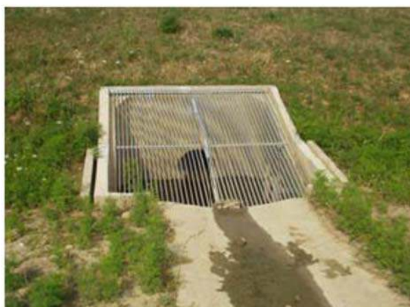
Figure 12 : Grille de protection sur ouvrage de sortie
