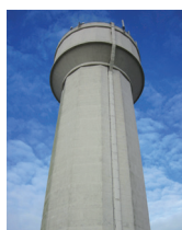
LES VERRERIES Réservoir sur tour 2 500 m 3
