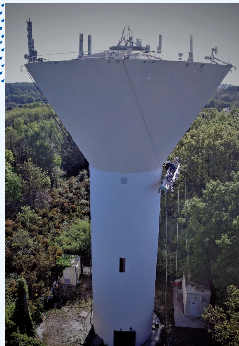
> Château d'eau Le Moulin Neuf 500 m 3 , rénové en 2017, Saint-Nicolas-de-Redon
