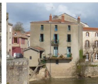
perte des encadrements de baies
