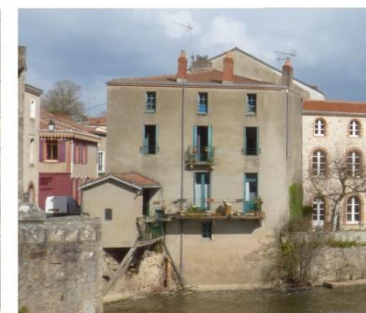
perte des encadrements de baies
