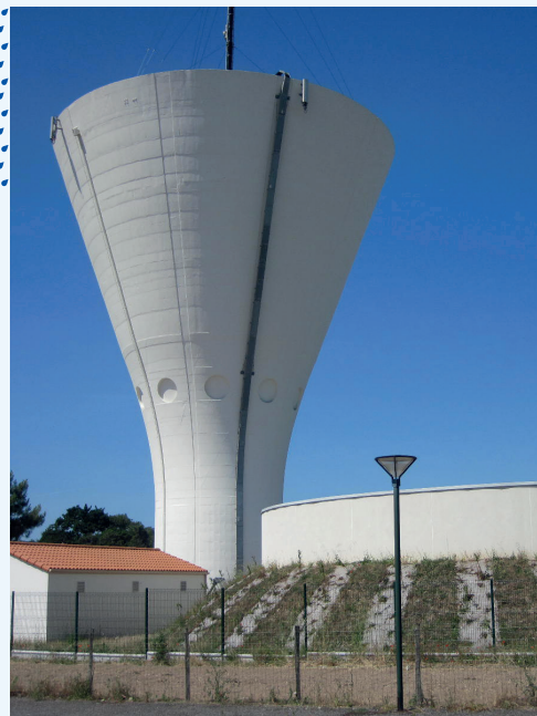
> Château d'eau La Hautière, 2 000 m 3 Saint-Brevin-les-Pins, rénové en 2017
