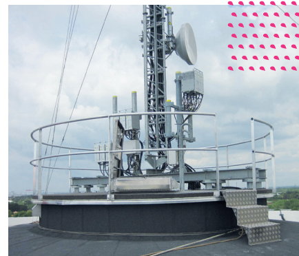
> Antennes sur le dôme du château d'eau de La Hautière à Saint-Brévin-Les-Pins
