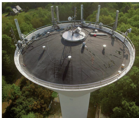
> Antennes en place sur le dôme du château d'eau de Saint-Nicolas-de-Redon
