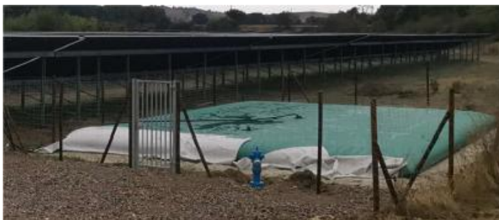
Exemple de citerne incendie souple - ©Enoe
