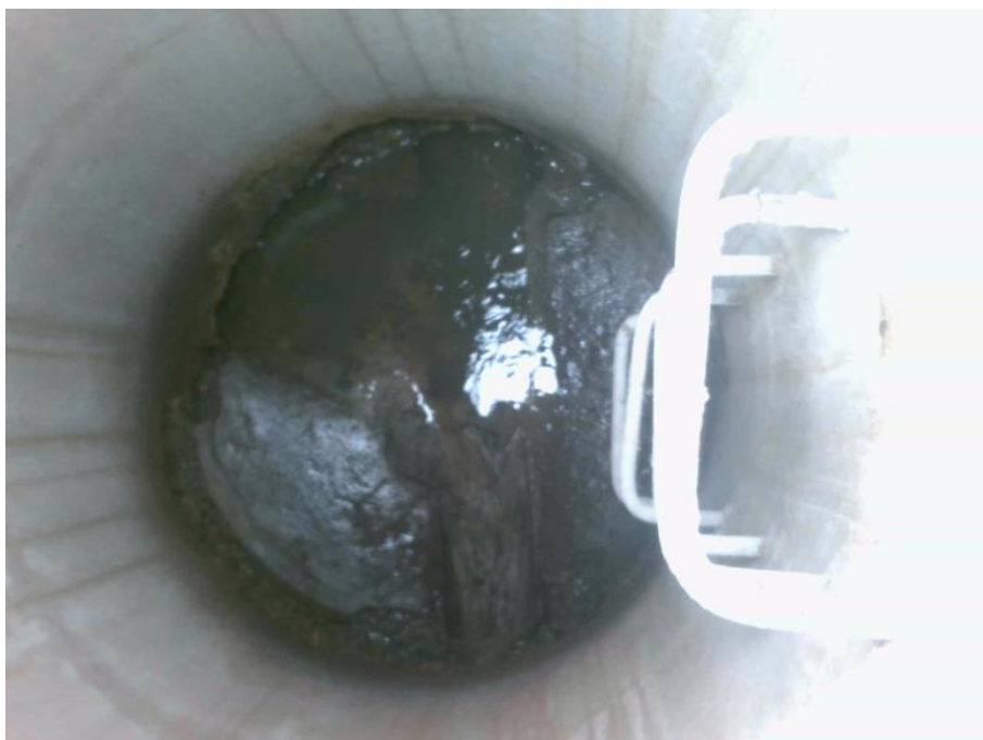
Présence importante de dépôts
