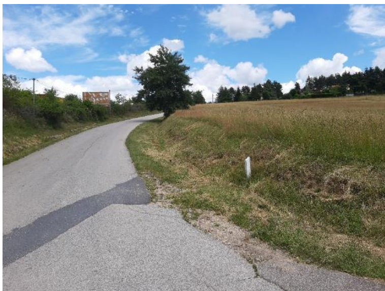
Photo prise le 18/06/20 – fossé inexistant suite aux travaux de raccordement AEP
