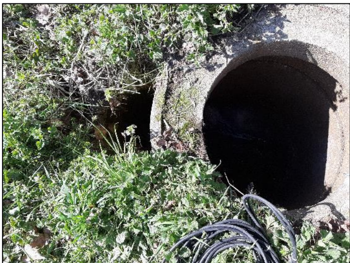
Regard non-étanche, entrée d'ECP en période de pluie et ressuyage
