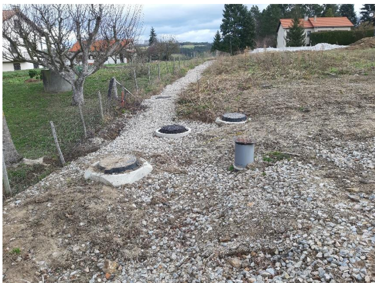
Photo prise le 16/01/20 – Ruissellement et graviers charriés suite à orages – chemin d'accès aux futures maisons
