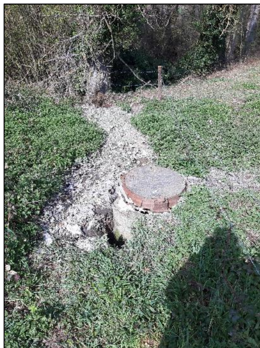
Mise en charge et rejets de lingettes vers le cours d'eau (13/04)
