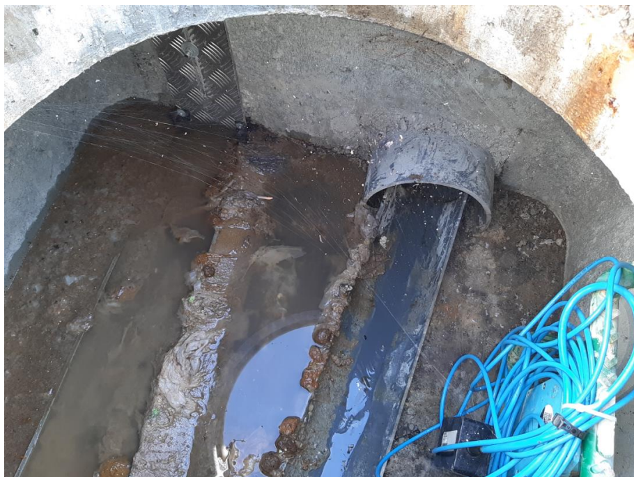
Photo prise le 30 mars à 15h36. Le départ était bouché. L'exploitant a fait le nécessaire pour le déboucher.
