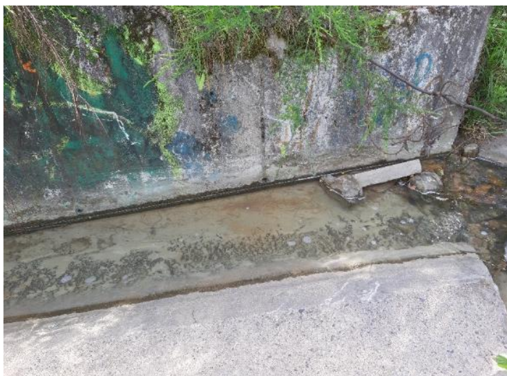
Photo prise le 18/06/20 – Présence de dépôts
