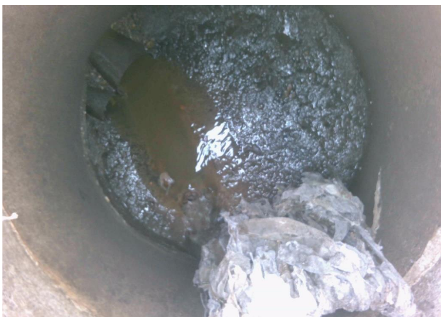
Présence importante de dépôts
