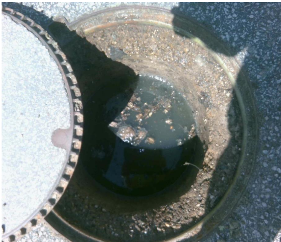
La présence d'un bouchon à l'aval est fort probable.
