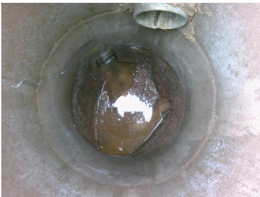
Présence importante de dépôts
