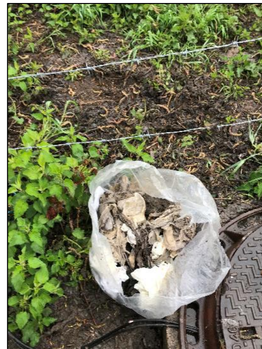
Nettoyage du regard par les services techniques (02/05)
