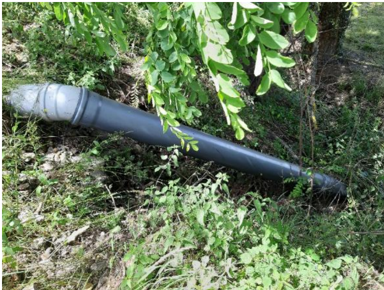
Photo prise le 18/06/20 – Érosion des berges
