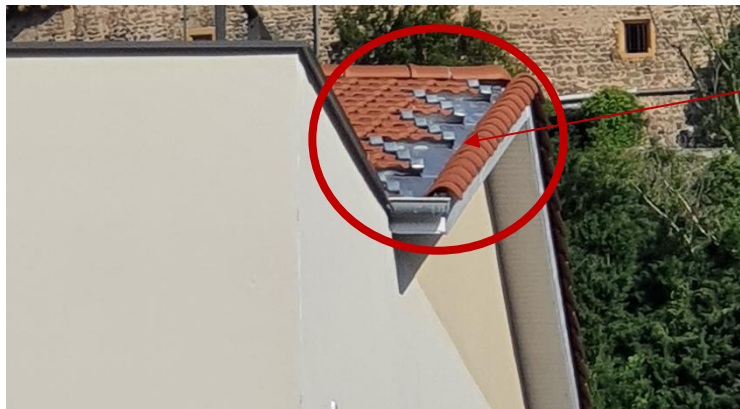
Type de « finition » de toiture interdite »
