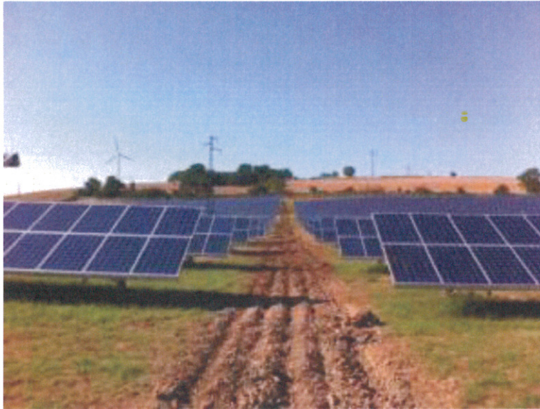
Exemple de Parc solaire à Avignonet-Laugarais (31)
