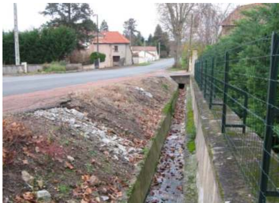
Fig. 25. Débordement du fossé en béton
