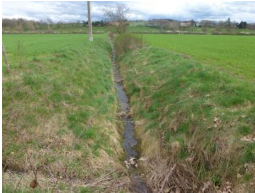
Fig. 22. Fossé enherbé pour la collecte des eaux pluviales
