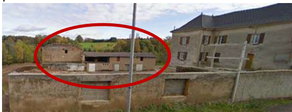
Bâtiment en partie démoli à la Gonine
