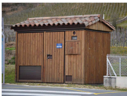
Exemple de local pour transformateur électrique
