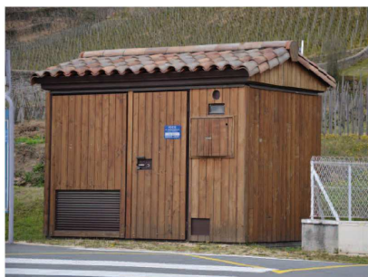
Exemple de local pour transformateur électrique
