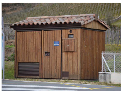
Exemple de local pour transformateur électrique
