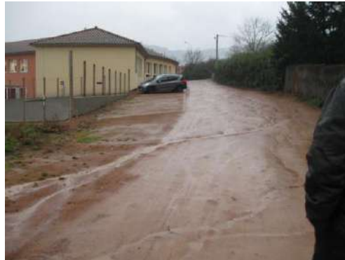
Fig. 32. Ruissellement des EP sur le chemin au nord de l'école – Saint-Alban-les-Eaux
