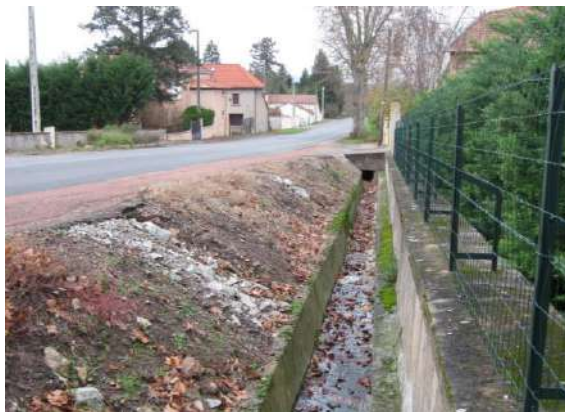
Fig. 25. Débordement du fossé en béton
