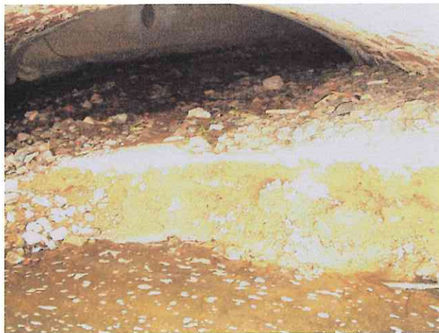
Figure 6 – Envasement sous le pont de l'usine (OH5)
