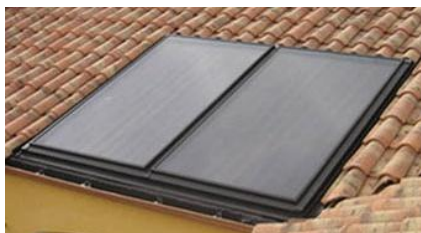
Exemple de panneaux solaires thermiques
