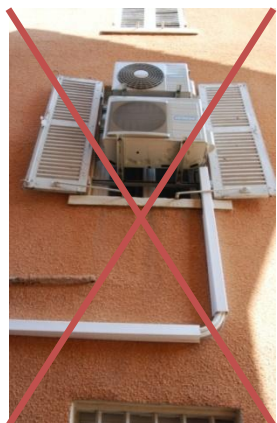
appareillage de climatisation rapporté
