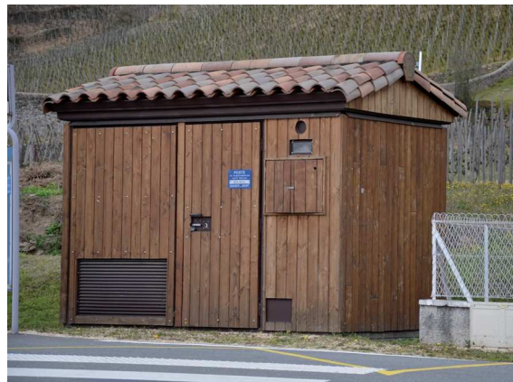
Exemple de local pour transformateur électrique
