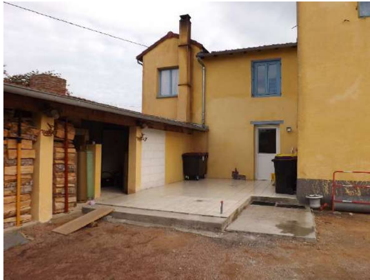
Côté sud-ouest de la dépendance du château pouvant faire l'objet d'une extension visant à agrandir les cuisines du restaurant situées au rez-de-chaussée.
