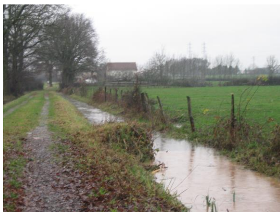
Fig. 29. Débordement de fossé – chemin de Maupassant
