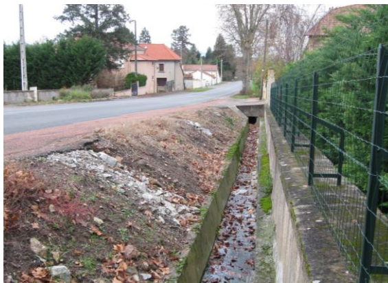
Fig. 25. Débordement du fossé en béton
