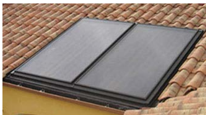
Exemple de panneaux solaires thermiques
