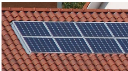
Exemple de panneaux solaires photovoltaïques
