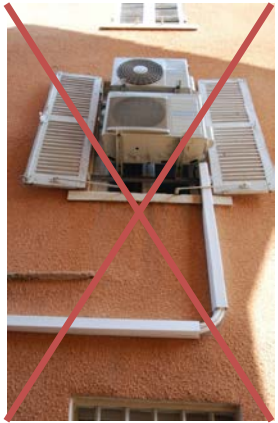
appareillage de climatisation rapporté
