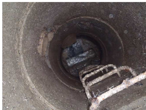
Branchement défectueux / Traces de mise en charge – Regard n°430 – Réseau eaux usées – Square du 11 novembre
