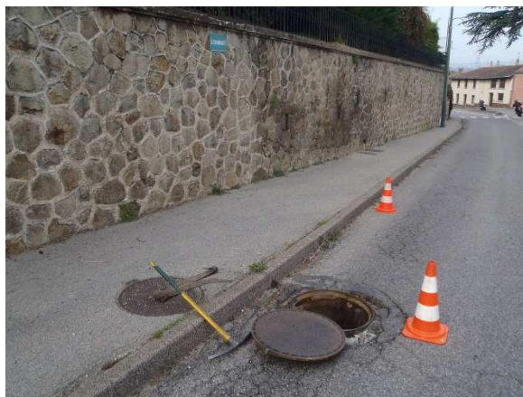
Affaissement tampon – Regard n°455 – Réseau eaux usées - D7 Chemin neuf
