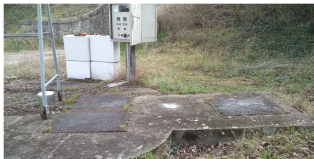
Extérieur PR6 - Verlieu – Eaux usées
