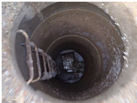
Traces de mise en charge – Regard n°41 – Réseau eaux usées – Avenue du Rhône
