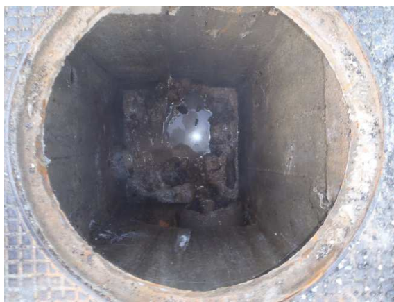
Absence de cunette / dépôts – Regard n°344 – Réseau eaux usées – Chemin des Lones
