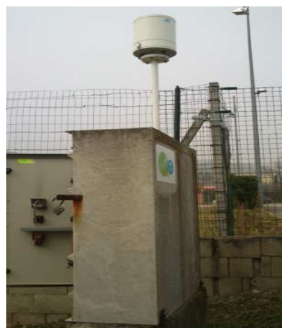
Armoire électrique et pluviomètre – PR Stade
