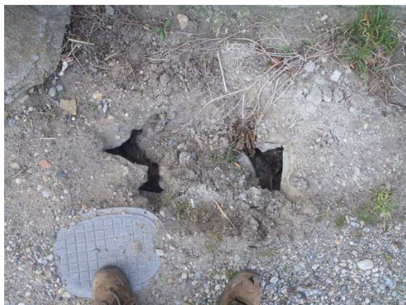
Orifice dans la conduite – Réseau pluvial - Départementale 1086, Verlieux
