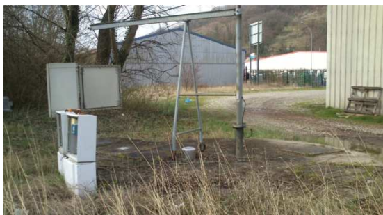
Extérieur PR6 - Verlieu – Eaux usées
