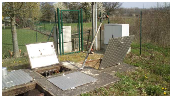
Extérieur PR2 – Grand Val – Eaux pluviales
