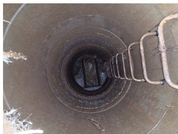
Racines – Regard n°45 – Réseau eaux usées – Derrière les terrains de tennis
