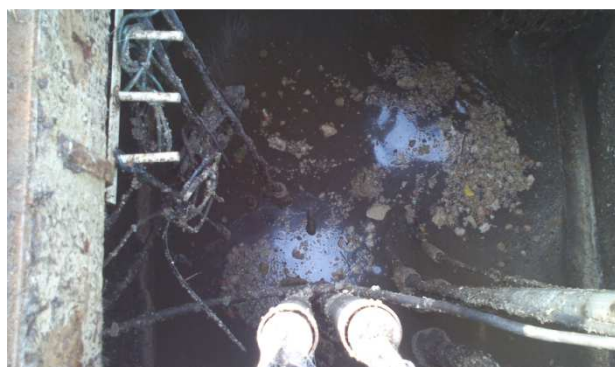
Intérieur PR8 - Grande Gorge – Eaux usées
