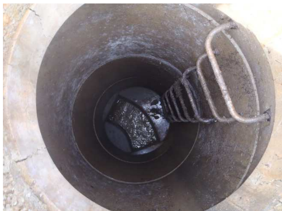
Couronne fissurée – Regard n°39 – Réseau eaux usées – Avenue du Rhône
