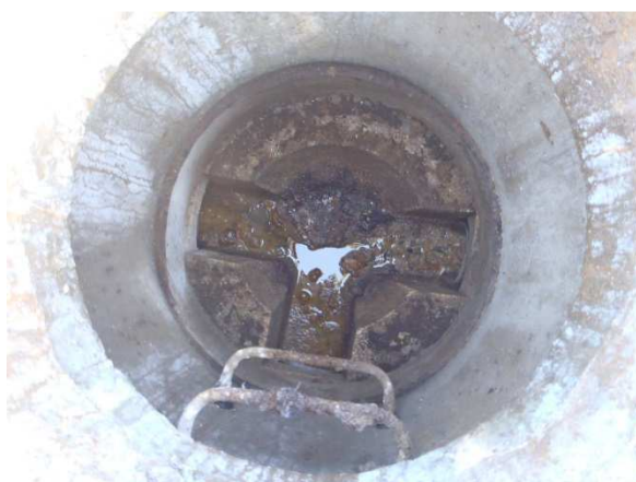
Dépôts – Regard n°1001 – Réseau eaux usées
