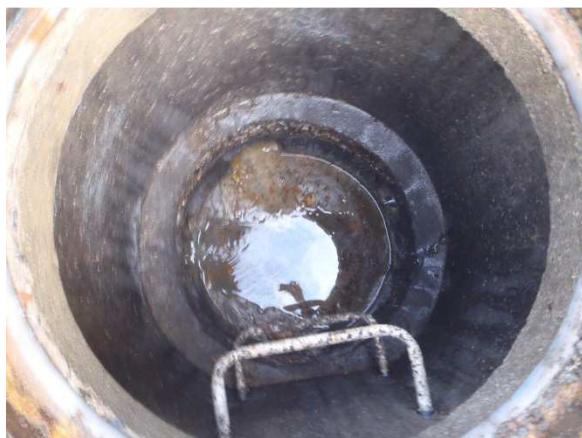
Dépôts/Absence de cunette/Racines – Regard n°3008 – Réseau unitaire
