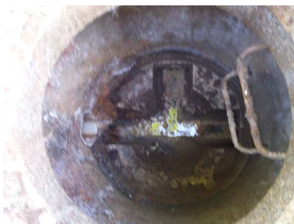
Racines – Regard n°1003 – Réseau eaux usées
