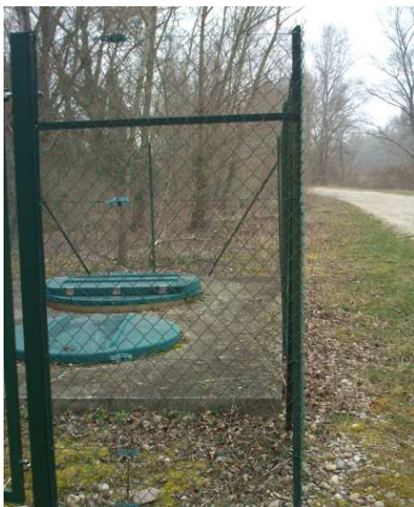
Vue extérieure – PR Jassoux Aval
