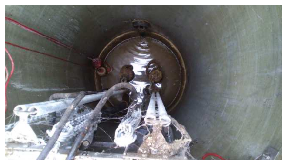
Intérieur PR9 – Chapois – Eaux usées
