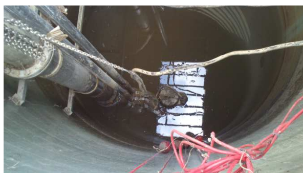
Intérieur PR4 – Les Sables – Eaux pluviales
