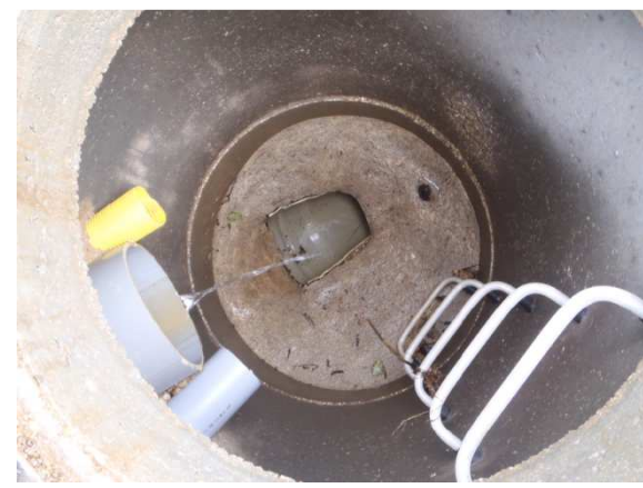
Fossé raccordé au réseau unitaire (Apport eaux claires parasites permanentes – Grande Gorge
