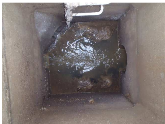
Absence de cunette / dépôts / stagnation d'effluent / traces de mise en charge – Regard n°395 – Réseau eaux usées – Avenue du Rhône
