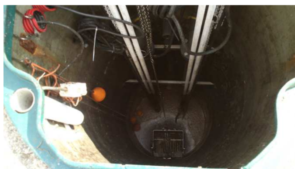
Intérieur PR1 – Grand Val – Eaux usées
