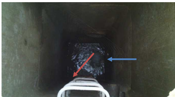
Regard en amont du PR du Stade (R903): Arrivée principale (en rouge) et Arrivée des eaux claires (en bleu)
