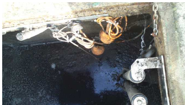
Intérieur PR2 – Grand Val – Eaux pluviales
