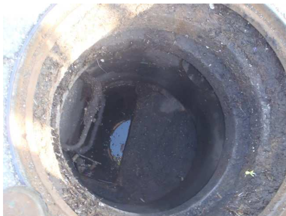
Limite de capacité – Regard n°260 – Réseau eaux usées – ZA Verlieu
