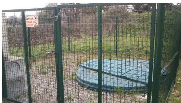
Extérieur PR4 – Les Sables – Eaux pluviales
