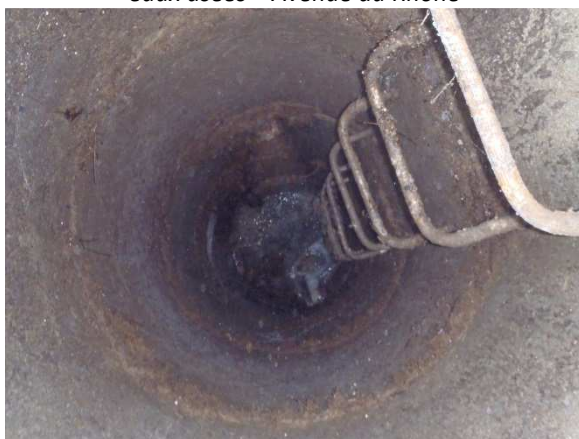
Absence de cunette / Racines – Regard n°429 – Réseau eaux usées – Square du 11 novembre
