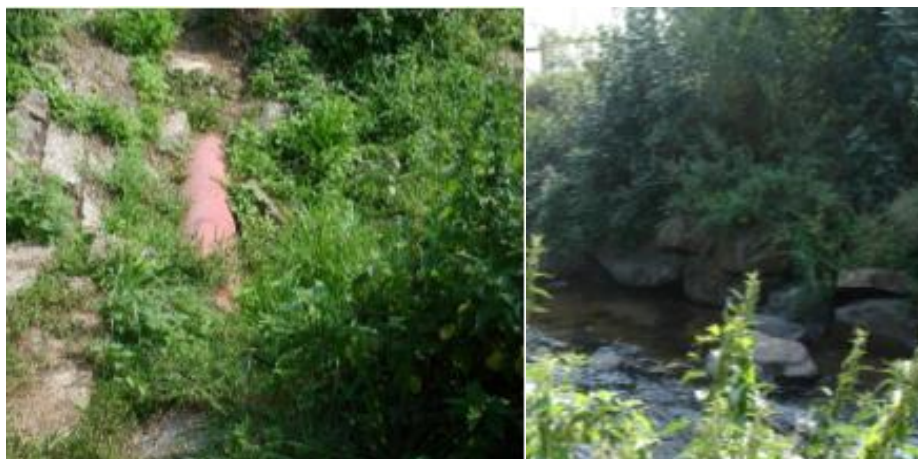
Secteur R4, Renaison, berges érodées
