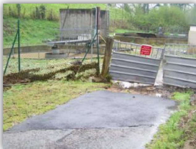
Figure 18 : Photos des dégâts à la station d'épuration après la crue du 2 mai 2013
