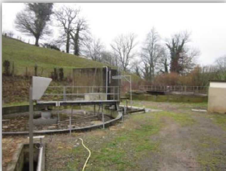
Figure 28 : Station d'épuration d'Aveizieux, vue sur le clarificateur et le bassin d'aération
