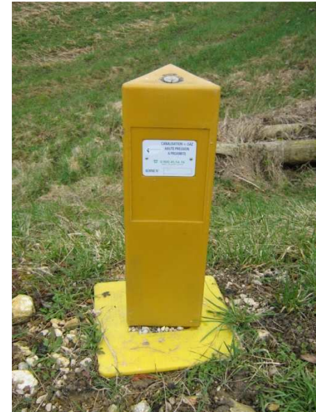
Borne de signalisation du passage de la canalisation de gaz
