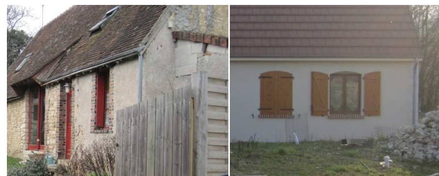
Appareillage en brique
