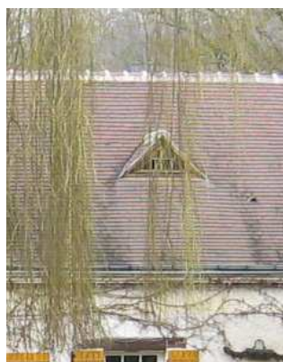
Houteau dans la toiture
